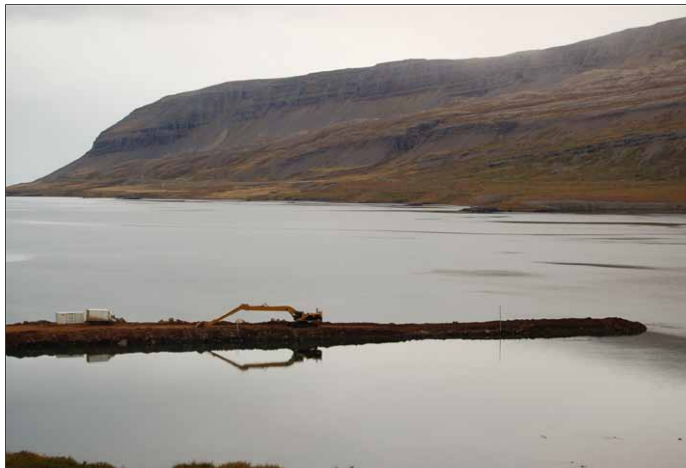
Vestfjarðavegur (60), Eiði - Þverá. Framkvæmdir í Kjálkafirði. Þegar fyllingar eru lagðar þarf sérstaklega að gæta að sigi. Fyllinguna þarf að leggja út í lögum til að botninn brotni ekki og efni tapist. Þess vegna var gert ráð fyrir að fyllingarnar í Mjóafirði og Kjálkafirði yrðu báðar lagðar út með pramma á sjó. Kjálkafjörður er grynri og fékk verktakinn heimild til að prófa að leggja fyllinguna út með löngum gröfjuarmi. Grafan nær 20 metra framfyrir sig og til hliðanna. Þetta hefur gengið vel en mjög vel er fylgst með sigi. Fyllingin hefur lengst um 5-8 m á dag. Sigurður Mar Óskarsson tók myndir á forsiðu og baksíðu 20. september 2012.
